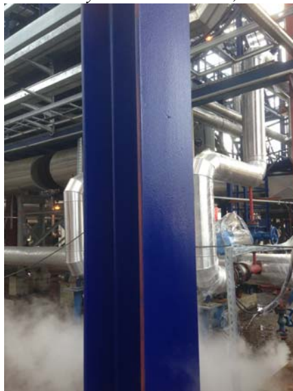
Рис.5. Силотерм ЭП-6М RAL 5003, установка ГОБKK, МНПЗ.
